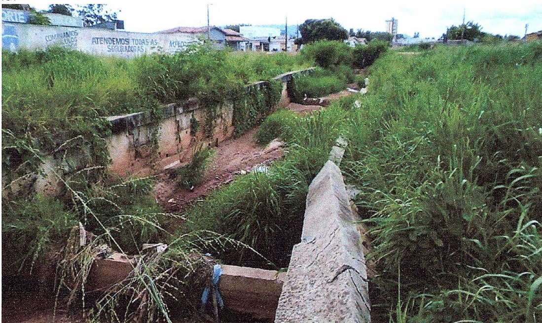
Figura 06 – Estrutura danificada, ocorrendo colapso devido os desmoronamentos do local. Estrutura nesse trecho não possui continuação e assim não possui os travamentos necessários.
