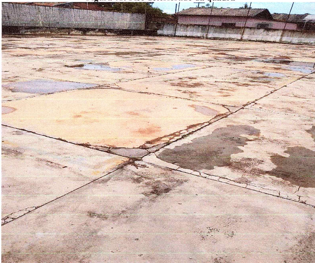
Figura 01: Piso deteriorado da quadra
