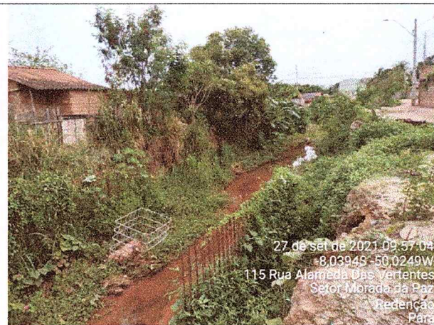
Figura 7 - Casas próximas ao perímetro da obra, onde será construído canal em calha de concreto moldado "in loco"
