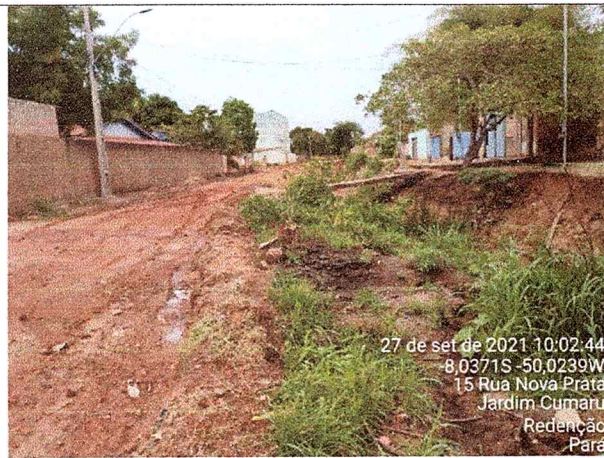
Figura 8 - Vista do local onde será construído canal em calha de concreto moldado "in loco"
