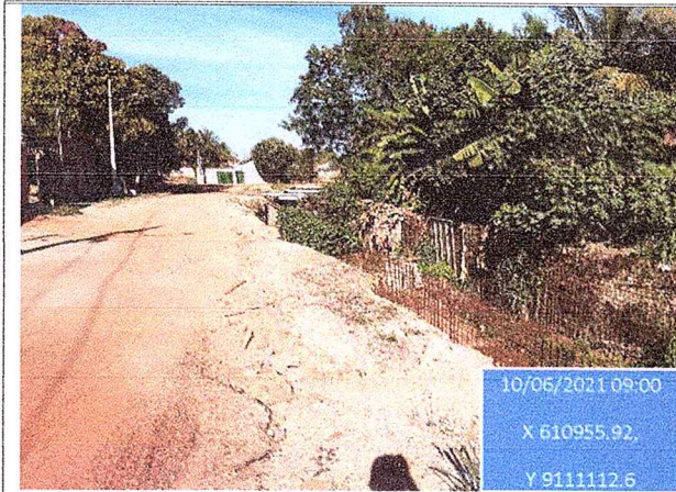
Figura 07 – Trecho da Etapa 02 do Canal Suprema Ferragem Exposta
