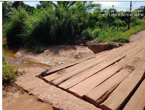
Figura 37/55 – Vista a jusante da ponte em madeira existente na Av. Marechal Rondon, próximo a Vila Gutierrez, que será substituída, com recursos próprios da PMR, por uma OAE Ponte em concreto armado nas dimensões da futura pista e com 7m de vão.
