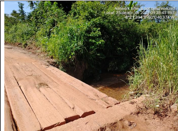
Figura 38/55 – Vista a montante da ponte em madeira existente na Av. Marechal Rondon, próximo a Vila Gutierrez, que será substituída, com recursos próprios da PMR, por uma OAE Ponte em concreto armado nas dimensões da futura pista e com 7m de vão.
